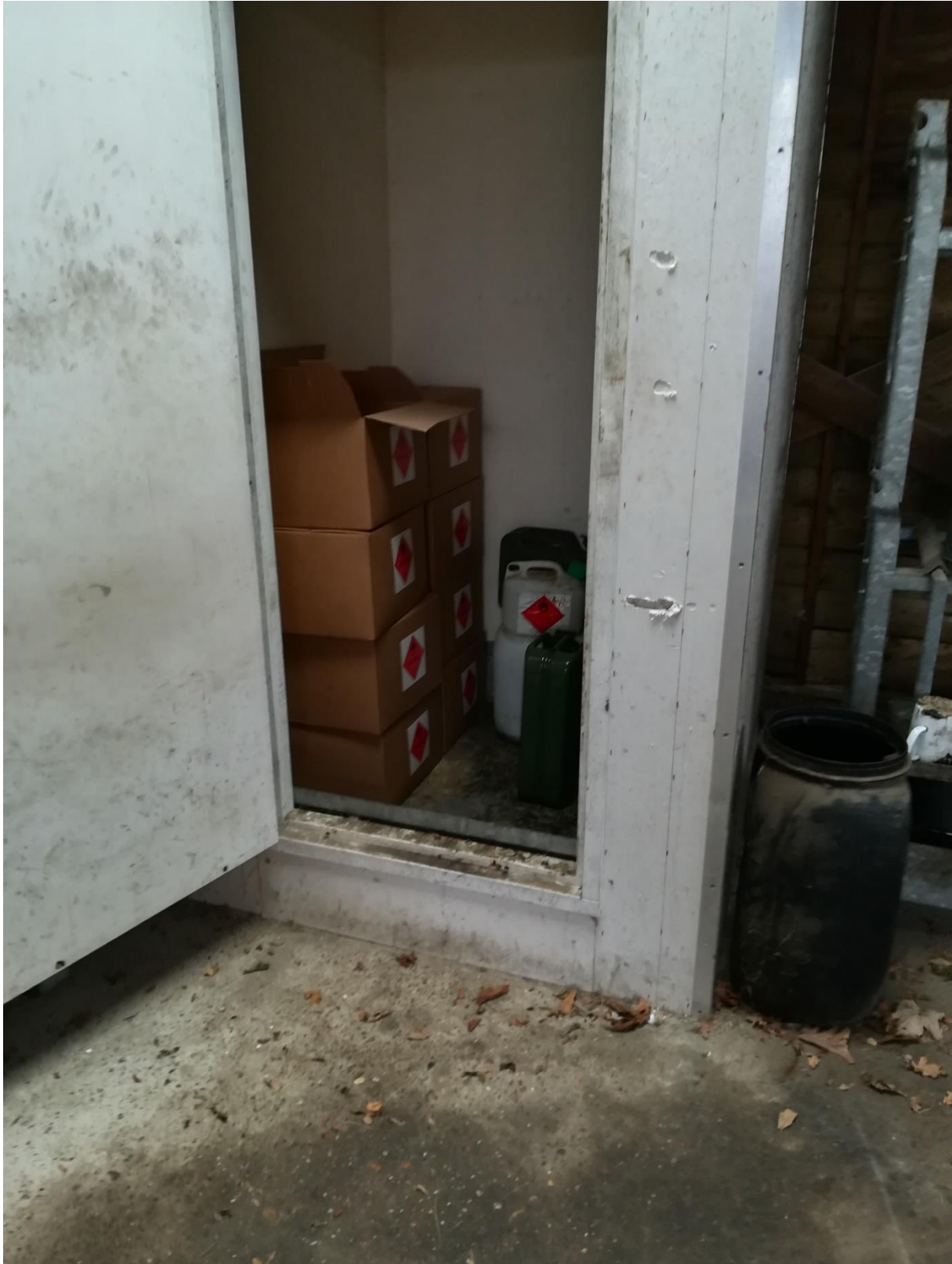
46. Opslag brandstof in kast met opvangbak in gebouw N
